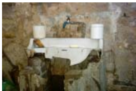
老朽化した洗面台
